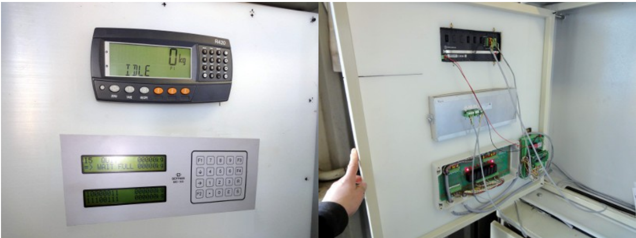
Geräte R420 und MC-XS in Schaltschranktür Geräte R420, MC-XS, PE1367 & Relaisbox in Schaltschranktür, Rückseite
